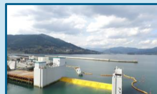
フラップゲート式 水害対策システム
