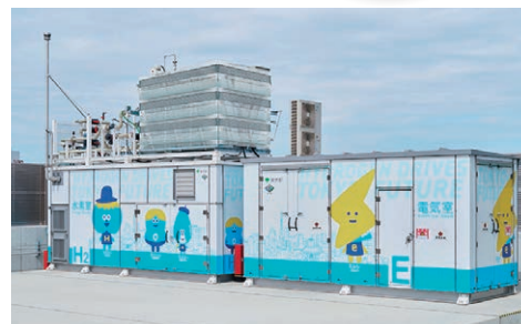
東京都京浜島1号向け水電解装置P2Gシステム
