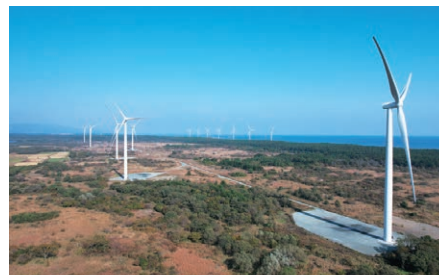
青森県北郡六ヶ所村で完工した陸上風力発電所
