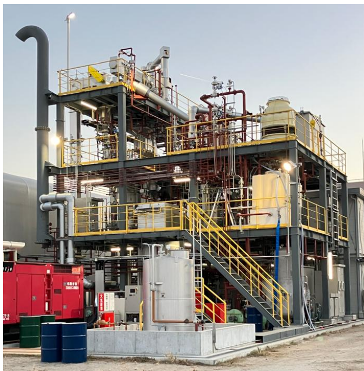
【パイロットプラントの外観】
