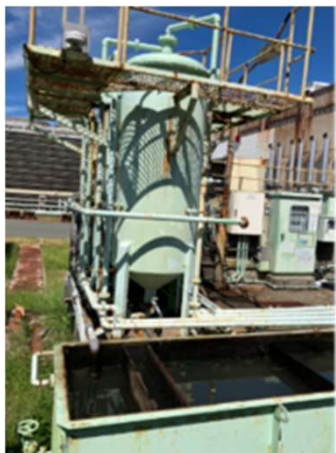
図4-4：油水分離槽(有明工場)
