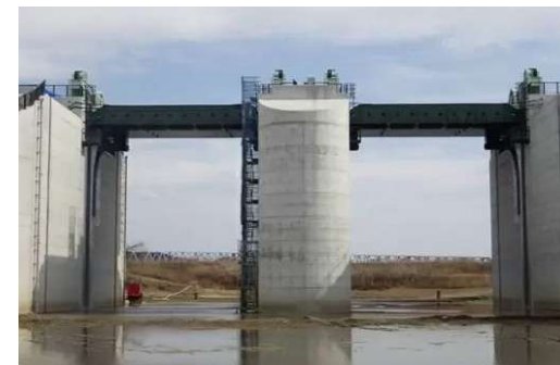
図A-2-3-1: 長島水門(横転式ローラーゲート)
