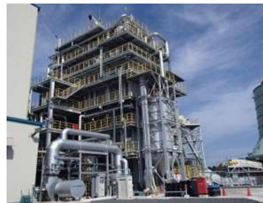
図A-2-4-4：ボイラ
