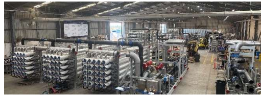
図A-2-1-5: RO型海水淡水化プラント
